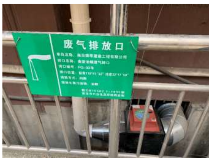
食堂油烟处理设施照片
