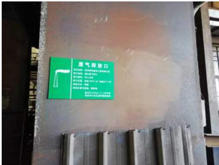
抛丸废气处理设施照片
