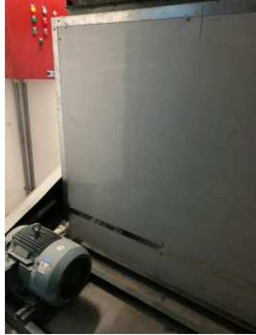
A 地块地下车库换风系统
