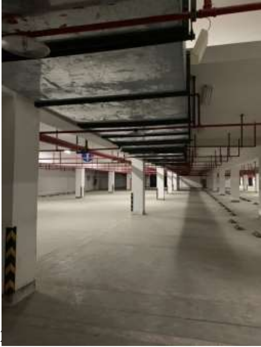
A 地块地下车库风管
