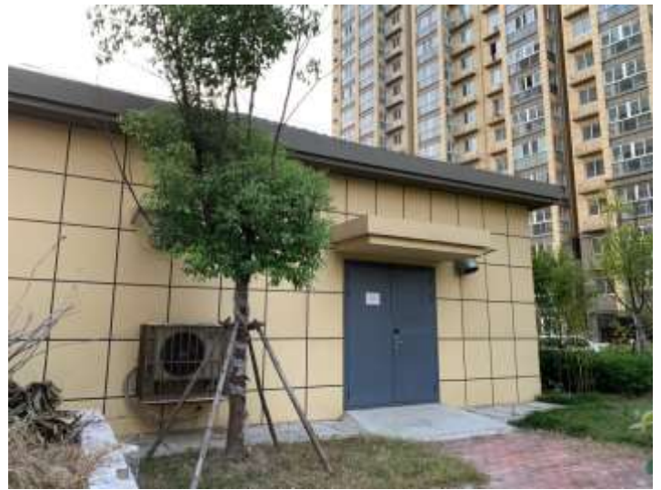
A 地块 3#配电所
