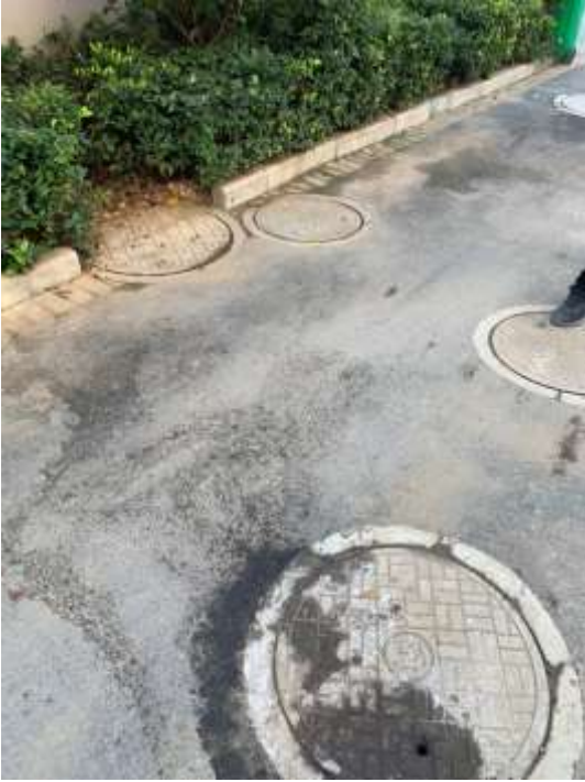
C 地块化粪池
